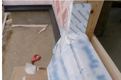
窓台に張った先張り防水シートのコーナー部は伸縮性のある防水テープを張る。
