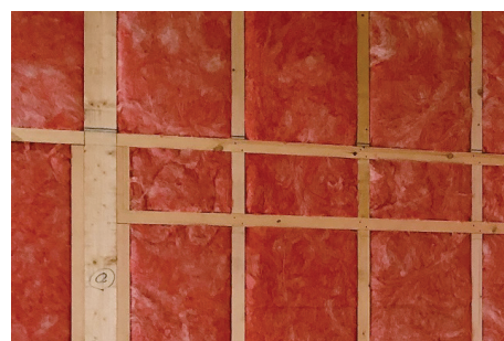
壁に断熱材（グラスウール）を充填したところ。断熱材の施工では、隙間なく隅々まで丁寧に充填することが重要なポイント。
